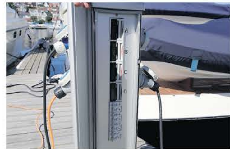
MODERNE: På Stathelle Marina er det strømuttak med egen kortleser for hver båt.
